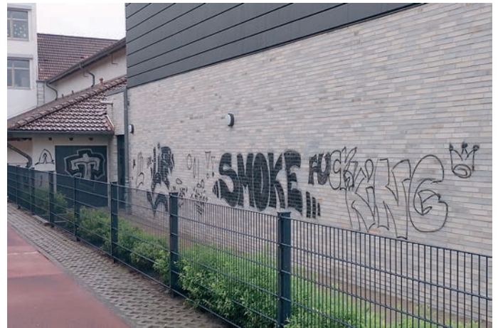
Das Foto zeigt die verunstaltete Wand der Turnhalle.
