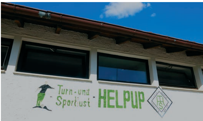
Der abgeblätterte Schriftzug entspricht dem Zustand des Gebäudes.
